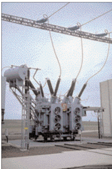
Eurotunnel : le poste d'interconnexion "Les Mandarins" de Bonningues-les-Calais.
